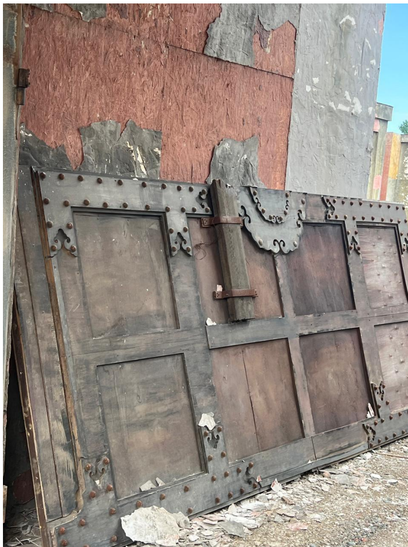
Фото 13. Демонтированные дверные полотна, прислонённые к ограждающей конструкции. Зафиксирована разукomплектованность дверных заполнений.
