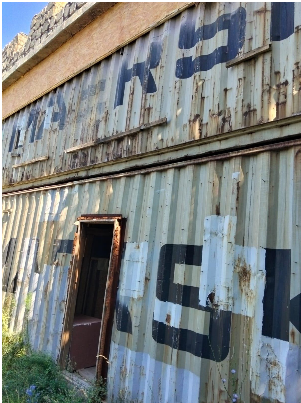
Фото 4. Вырезанный проем в боковой стенке контейнера с металлическим обрамлением; по поверхности фиксируются коррозия, следы сварочных переделок и повреждение защитного покрытия.
