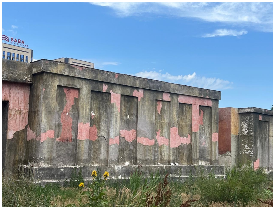
Фото 10. Фасадная плоскость с многочисленными участками отслоения и разрушения декоративно-защитного слоя.
