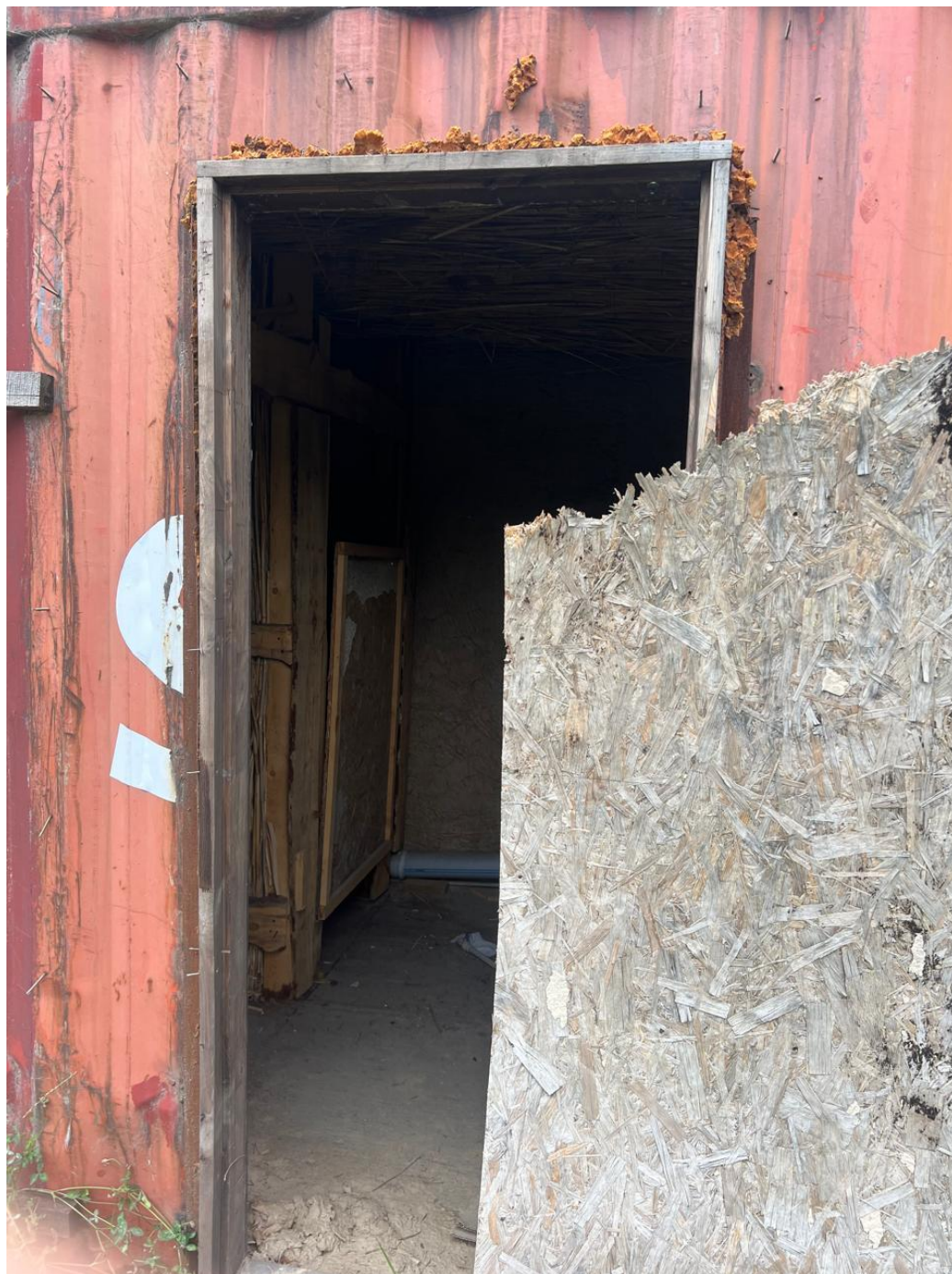
Фото 1. Сквозной вырезанный проем в боковой стенке контейнера. Удалена значительная часть профилированной обшивки; нарушена сплошность заводской оболочки.
