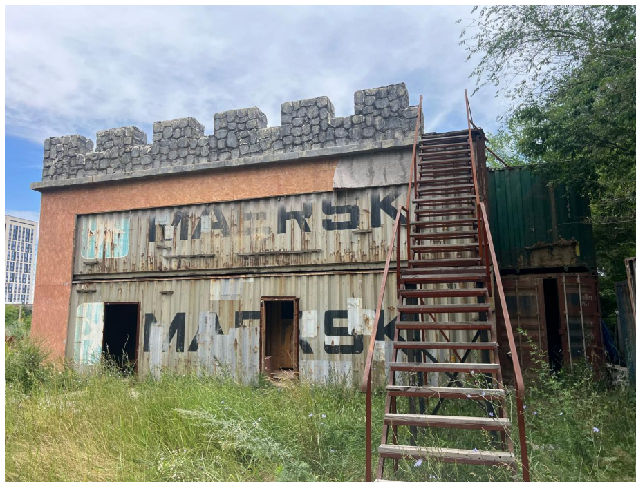
Фото 20. Контейнерный блок с наружной металлической лестницей. В стеновых панелях контейнеров выполнены проёмы и вырезы, изменяющие первоначальную целостность заводской ограждающей оболочки.
