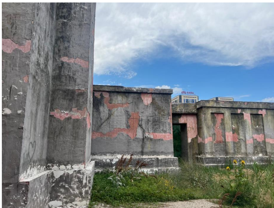
Фото 7. Фрагмент фасадных ограждающих конструкций. Зафиксированы отслоение и утрата отдельных участков декоративно-защитного покрытия.
