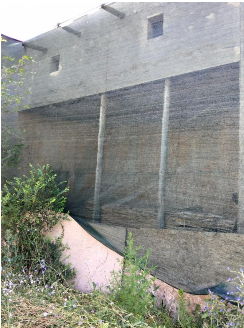
Фото 27. Общий вид наружной декоративной стены с лёгкой сетчатой оболочкой. Зафиксированы деформация ограждающего материала и неудовлетворительное состояние нижнего примыкания.
