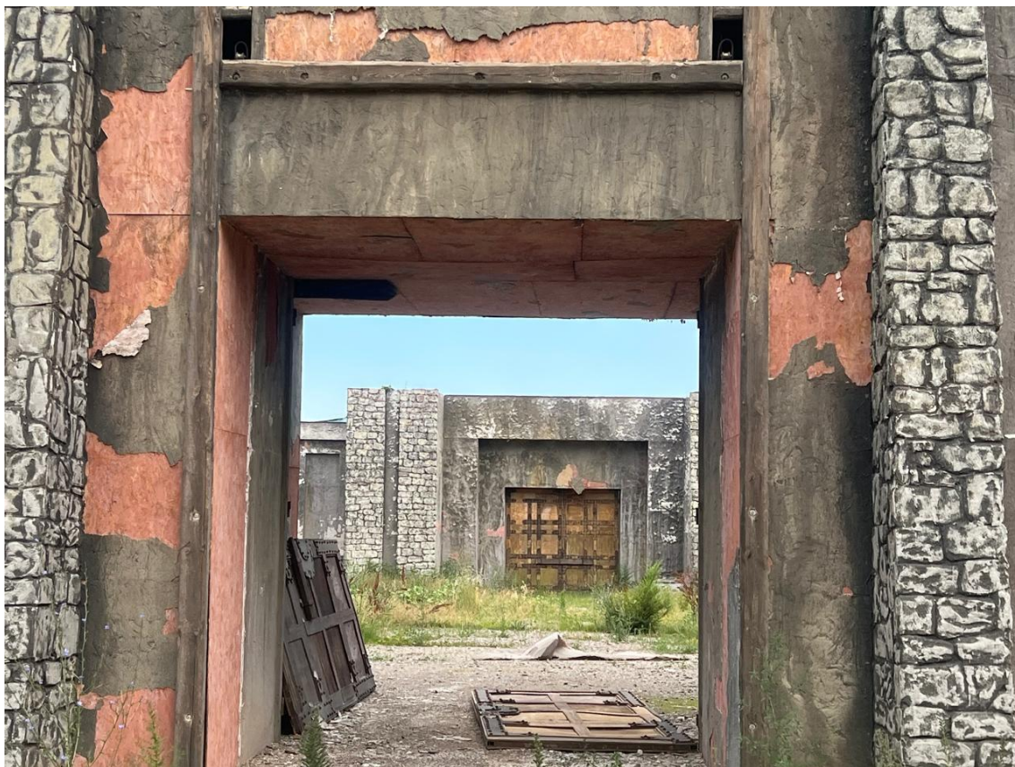
Фото 14. Открытый проход в декоративной стене. Видны демонтированные дверные полотна и повреждение прилегающей облицовки.
