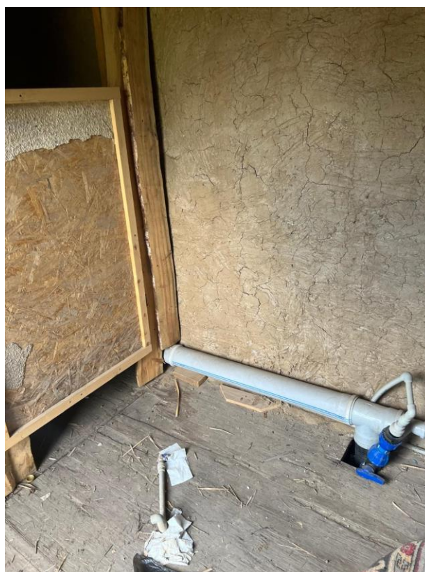
Фото 21. Фрагмент внутренней отделки временного помещения. Наблюдаются сетка поверхностных трещин/растрескивание отделочного слоя и открытая прокладка санитарно-технических элементов.
