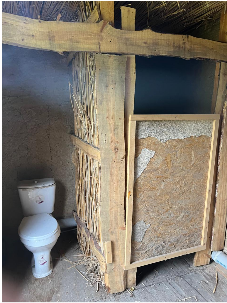
Фото 22. Лёгкая деревянная каркасно-листовая перегородка и санитарно-технический прибор. Видны повреждение отделочного слоя и временный характер внутреннего обустройства.
