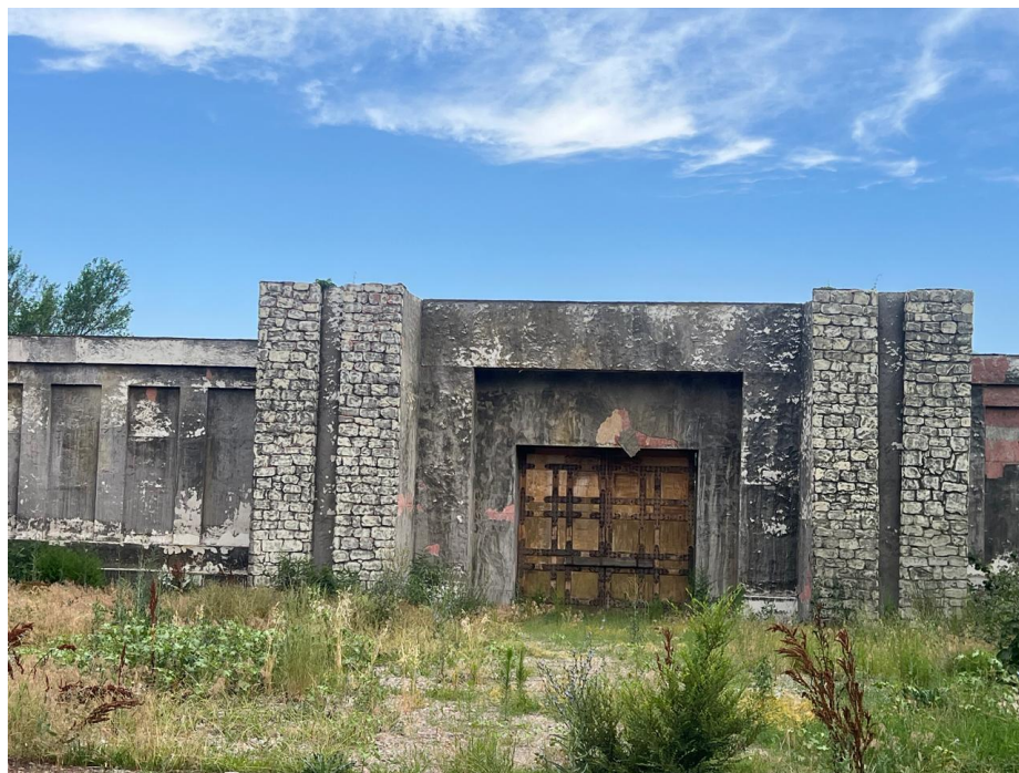
Фото 8. Фасадная часть объекта с входным проёмом. Видны признаки длительного атмосферного воздействия и деградации декоративной отделки.
