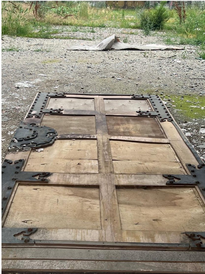
Фото 12. Демонтированное массивное дверное полотно, складированное на территории объекта. Нештатное положение тяжёлого элемента создаёт дополнительную травмоопасность.
