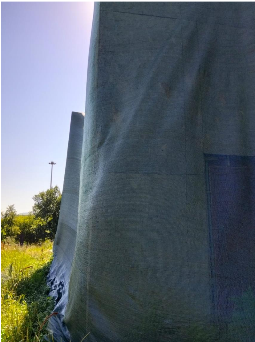
Фото 24. Боковой вид лёгкого наружного ограждения. Наблюдаются деформация, провисание материала и нарушение примыкания к основанию.
