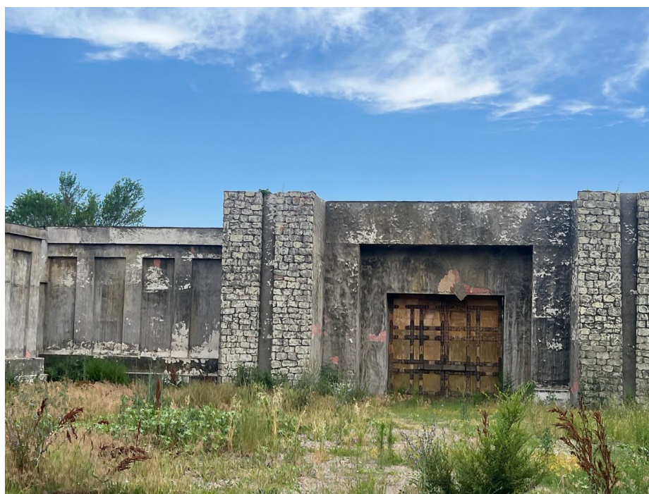
Фото 9. Общий вид входного портала и прилегающих фасадных элементов. Нарушена целостность и сохранность наружного декоративного покрытия.
