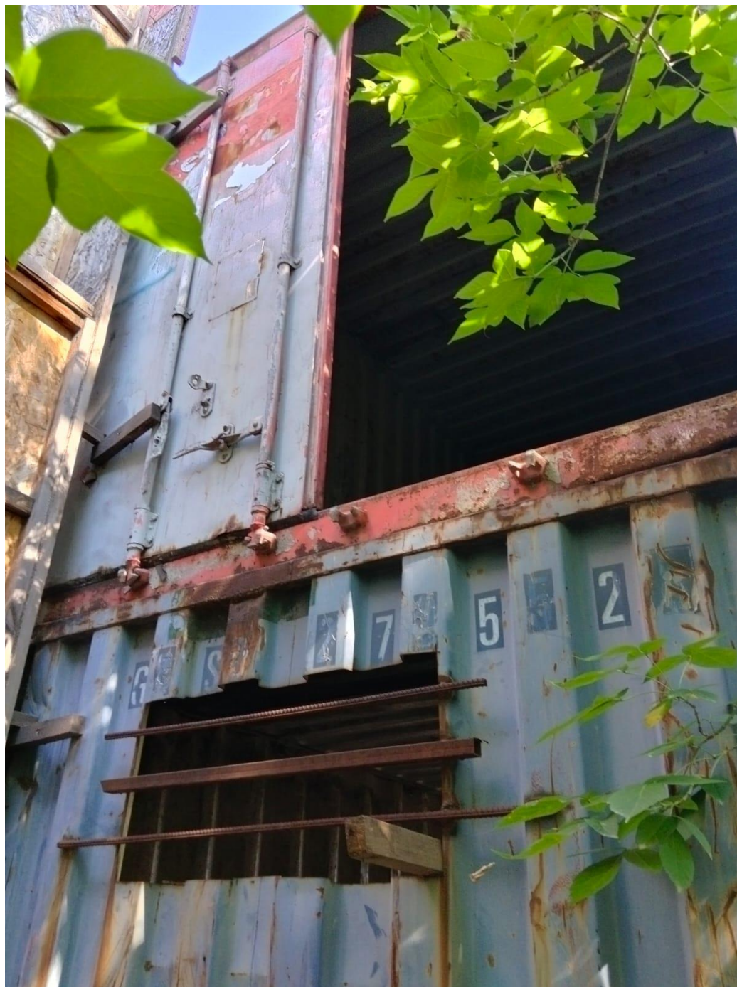
Фото 3. Многочисленные проемы и разрезы в боковых стенках контейнерных блоков. Видно удаление участков профилированного металла и изменение исходной конструктивной схемы.
