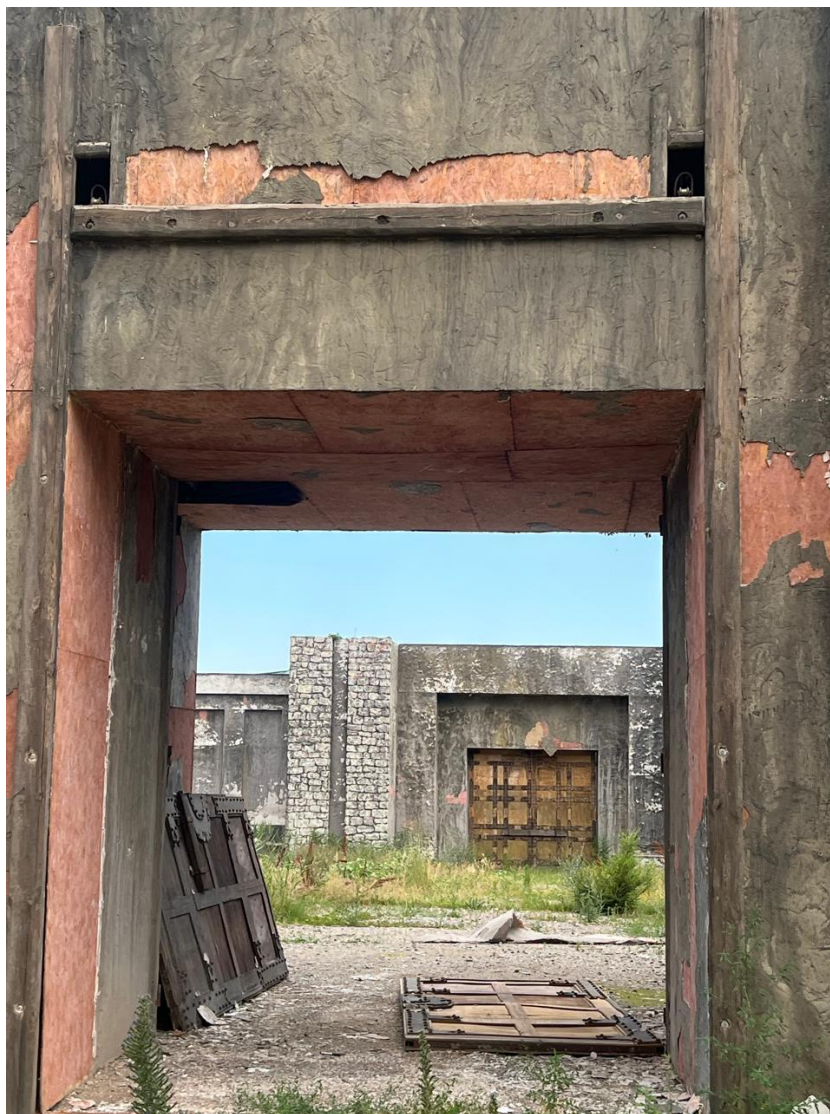
Фото 15 Крупный план открытого проёма. Нарушена комплектность ограждения, имеются участки разрушенной декоративной отделки.
