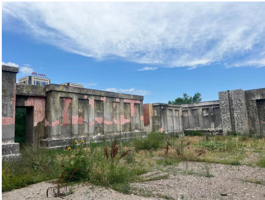
Фото 6. Общий вид внутренней территории декорационного комплекса. Наблюдаются разрушение наружной отделки, атмосферное старение и зарастание территории.
