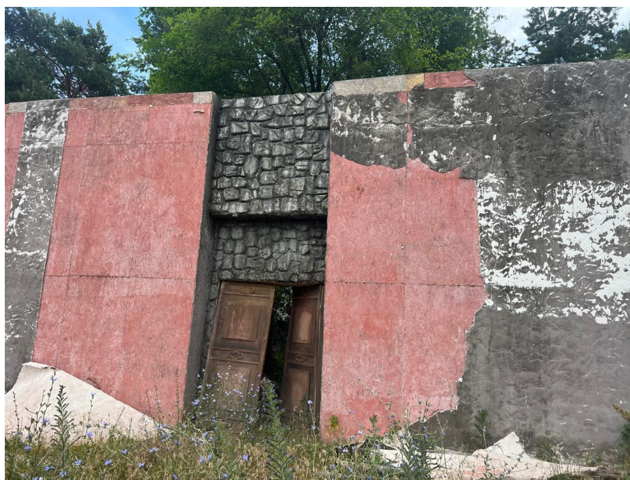
Фото 17. Фрагмент наружного ограждения с локальным разрушением облицовки и разукомплектованным проёмом.
