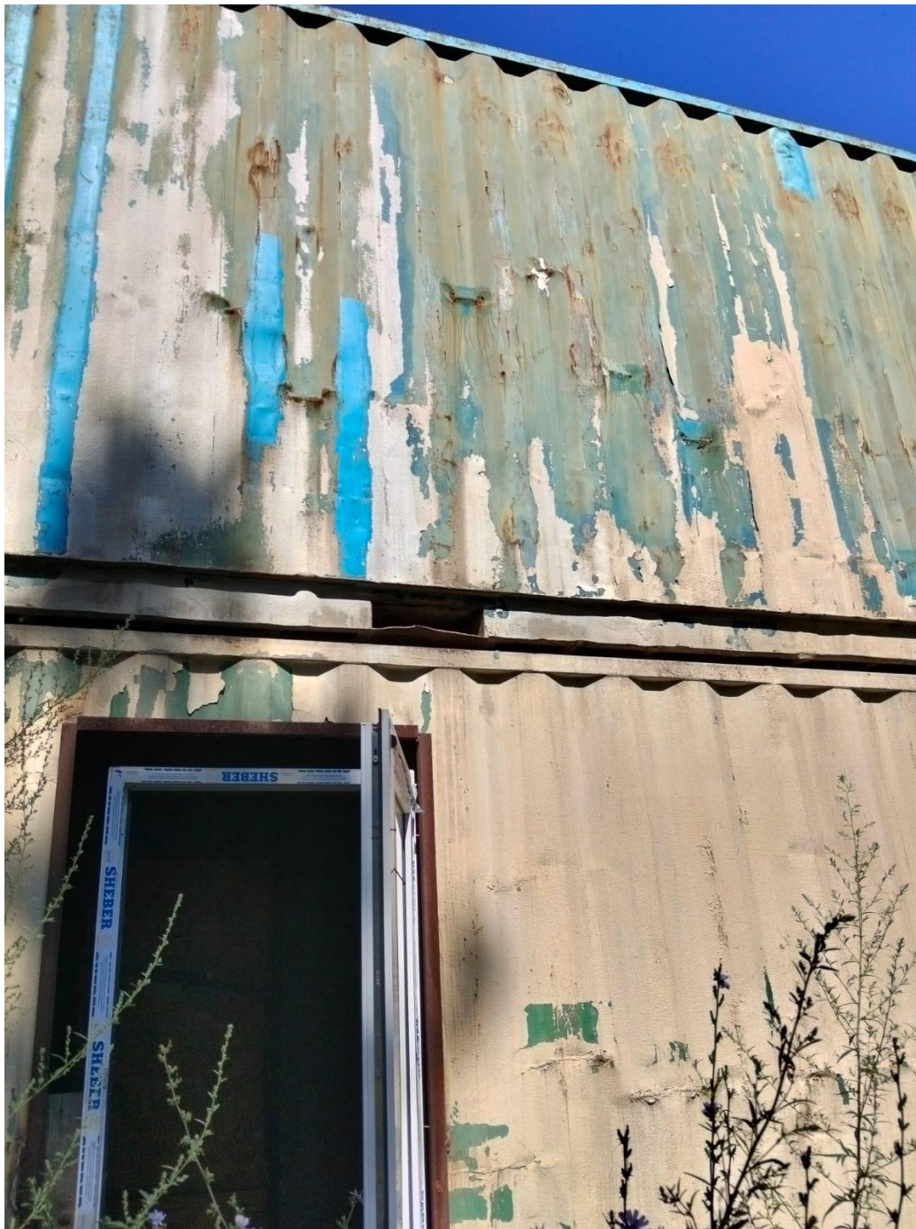
Фото 5. Вырезанный проем в стенке контейнера и нарушение целостности ограждающей оболочки. Повреждения подтверждают невозможность безопасного повторного использования контейнеров после демонтажа.
