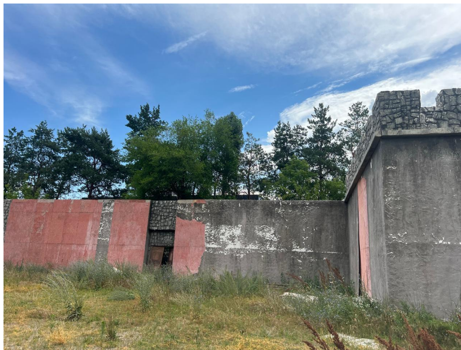
Фото 18. Общий вид внутренней территории объекта. Наблюдаются зарастание растительностью и отсутствие эксплуатационного содержания территории.
