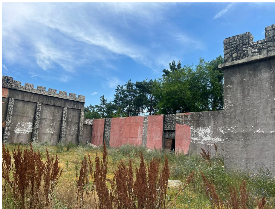
Фото 19. Общий вид участка между декоративными стенами. Зафиксированы зарастание территории и неудовлетворительное состояние наружных ограждающих элементов.
