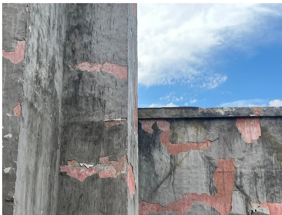
Фото 11. Крупный план повреждённой наружной отделки. Наблюдается отслоение покрытия с оголением основания декоративной конструкции.
